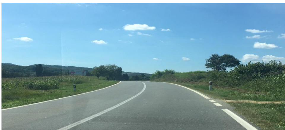
Fotografija 4. Dio ceste u usjeku prije mjesta Zakorenje s nedovoljnom preglednošću
