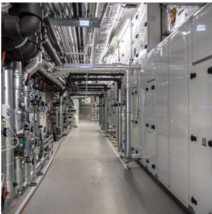
Slika 2. Vizuelni prikaz klima komora smještenih u mašinskoj prostoriji
